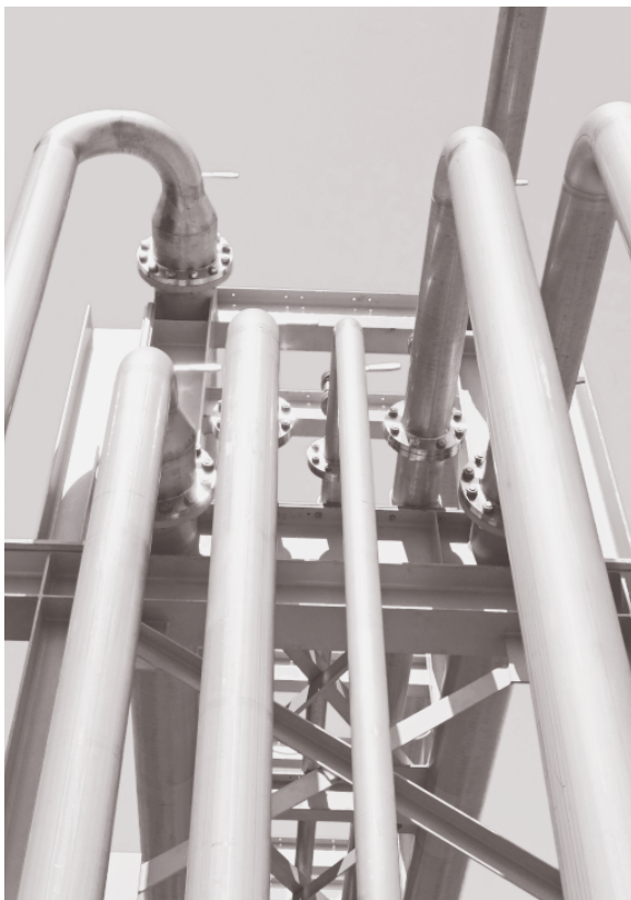
Rohrbrücke beim Umschlagplatz von Benoil SA, in Rancate
